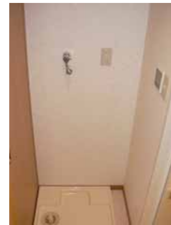
室内洗濯機パン
